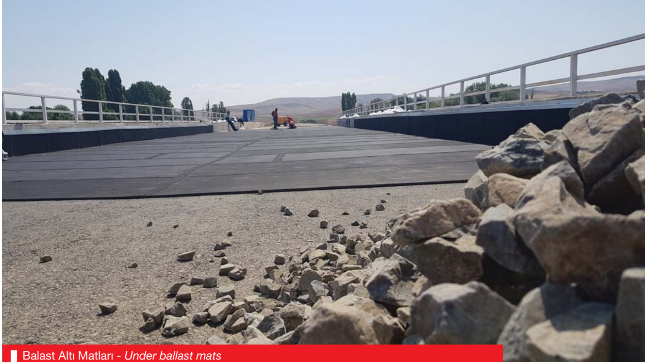
Balast Altı Matları - Under ballast mats
