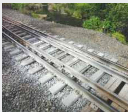
Ungleiche Belastungen der Weiche verursachen Schotterverschleiß und „White Spots“.
