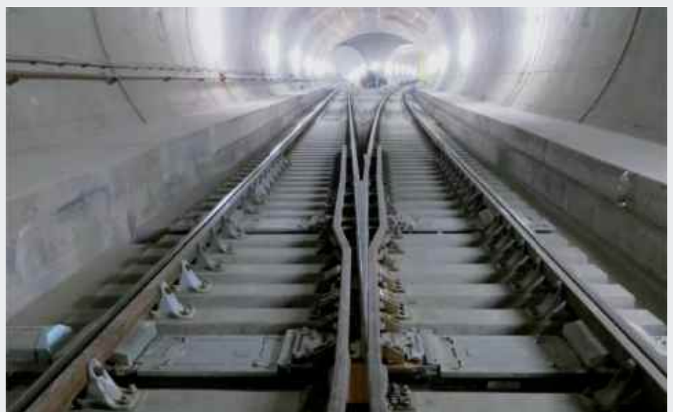
Auf Masse-Feder-System gelagerte Weiche
