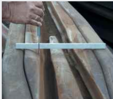
Schäden an den Schienen und am Herzstück der Weiche
