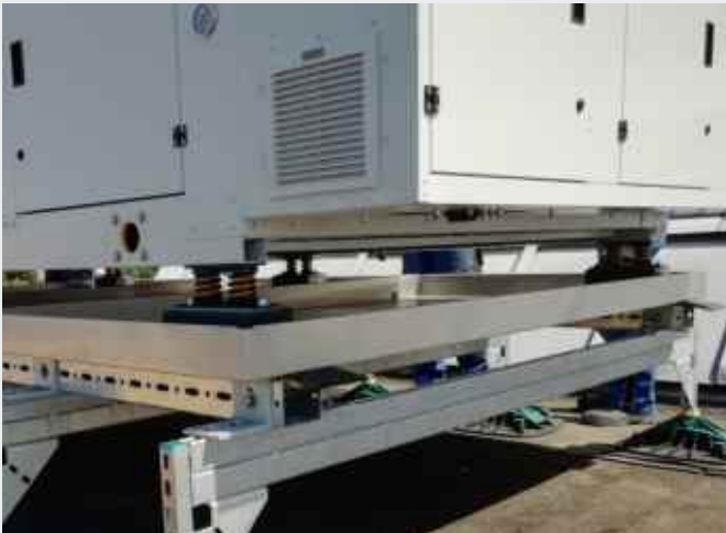
Geräteaufstellung in der Auffangwanne
