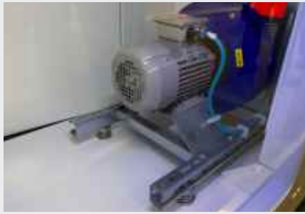
Radialventilator in einer RLT-Anlage
