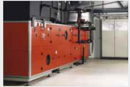
Im Keller aufgestellte RLT-Anlage
