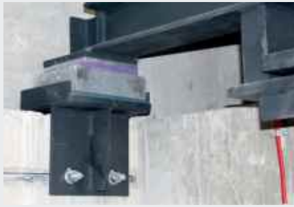
Lagerung einer Aufzugsanlage mit Seilträger im Schachtkopf
