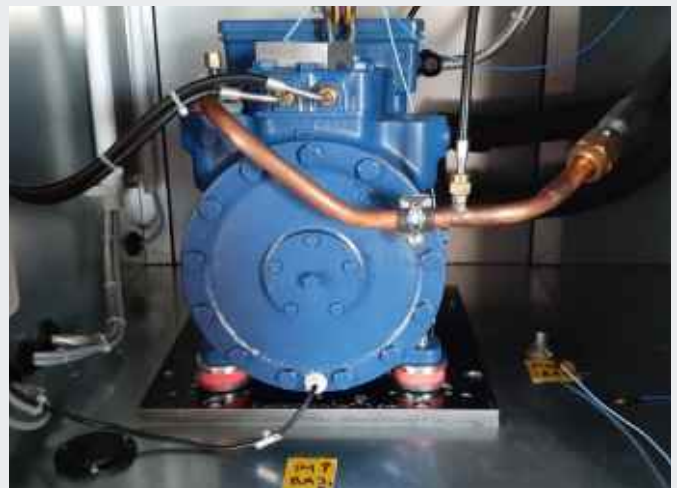
Lagerung eines Hubkolbenkompressors mit Isotop® Compact
