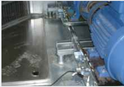
Lagerung von riemengetriebenen Ventilatoren
