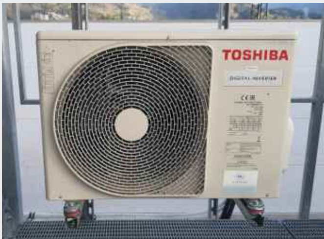
Klimagerät Außeneinheit auf Wandhalterung
