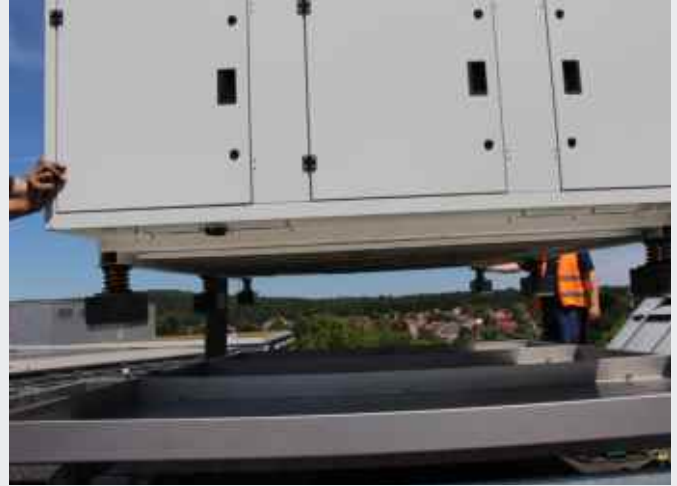
Geräteaufstellung mit vormontierten Isotop® DT
