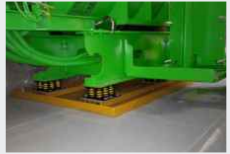
Großes Blockheizkraftwerk mit vielen Start- und Abschaltzyklen
