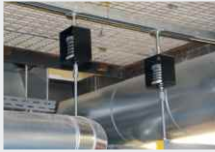
Entkoppelte Rohrleitungen mit Isotop® SD/Z
