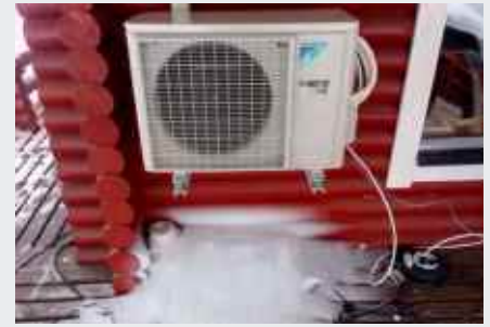
Außeneinheit einer Wärmepumpe auf Wandhalterung
