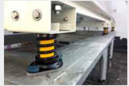
Rückkühler auf Dach installiert
