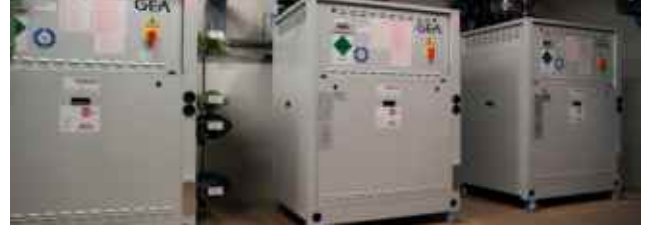
Erfolgreiche Lagerung der Kälteanlagen auf dem Dachboden
