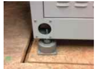
Bestehende unzureichende Maschinenlager Vibrostop
