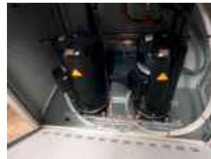
Installierte Scroll Kompressoren
