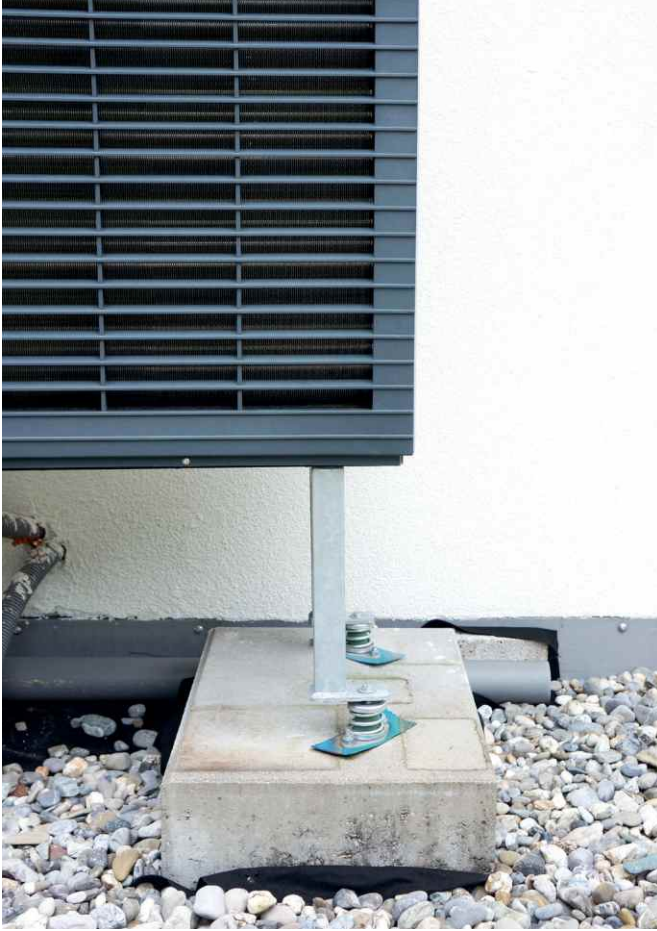
Lagerung einer Ausseneinheit am Boden (Fundament) mit Isotop® MSN-Elementen
