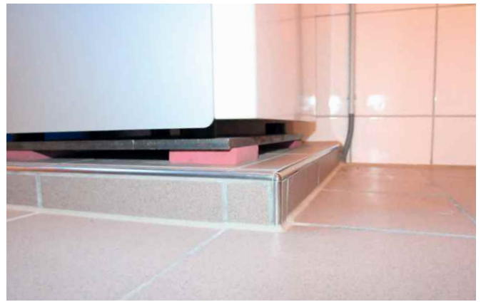
Entkopplung einer Inneneinheit auf Sylomer® Punktlager
