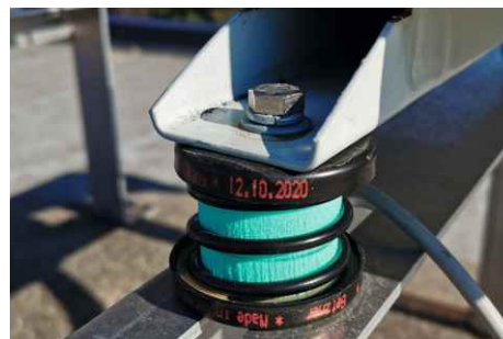
Lagerung einer Wärmepumpe mit Isotop® DMSN
