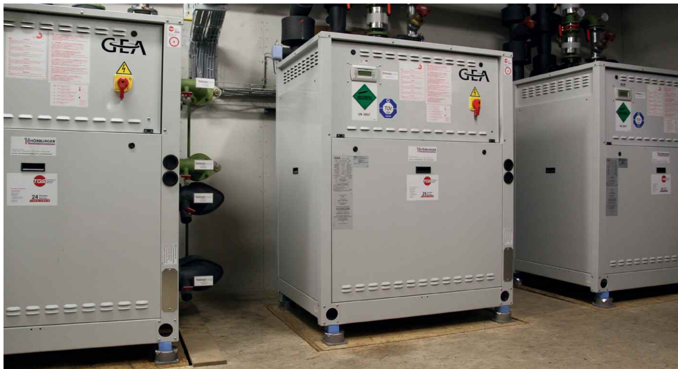
Isolamento antivibrante efficace del sistema di raffreddamento nell'area del tetto
