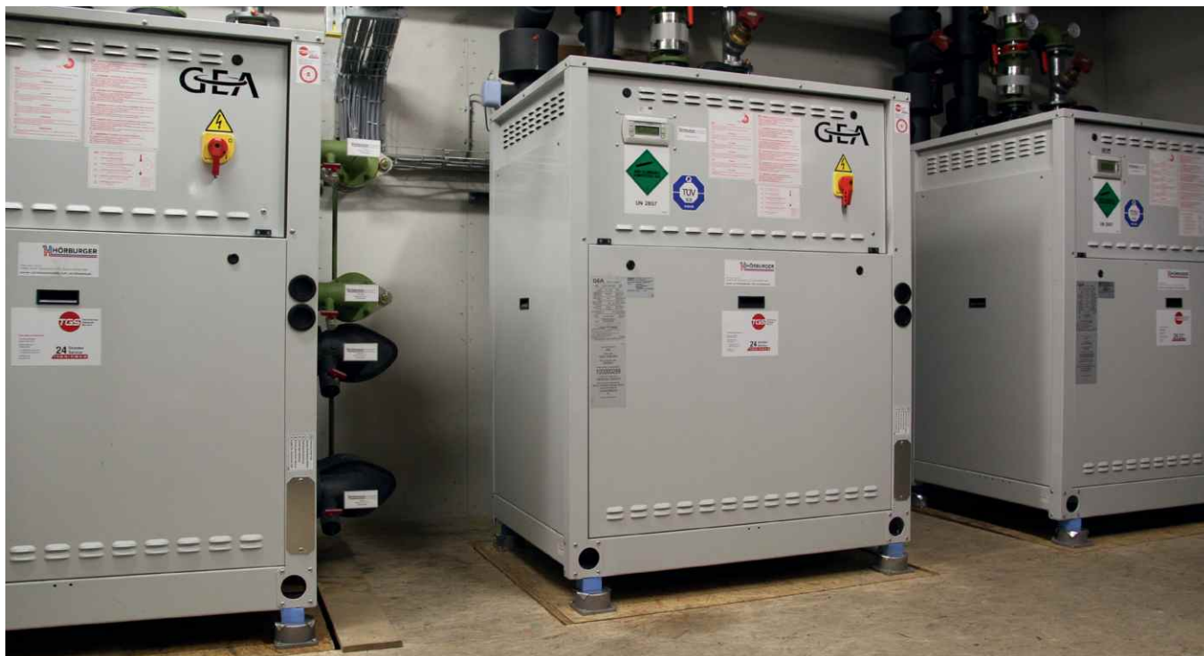
Appui efficace de l'installation frigorifique dans la zone de toit
