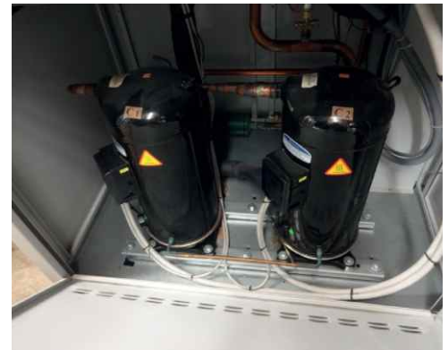
In das System eingebaute Scrollkompressoren
