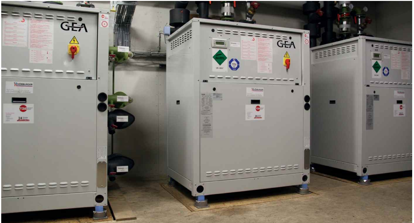
Effektive Lagerung der Kühlanlage im Dachbereich
