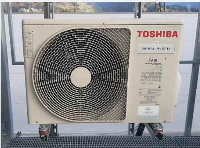
Klimagerät Außeneinheit auf Wandhalterung
