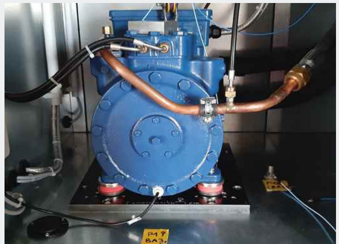
Lagerung eines Hubkolbenkompressors mit Isotop® Compact
