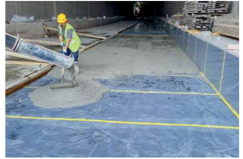
Dank der vollflächig verlegten Masse-Feder-Systeme werden Schwingungen auf der Hochgeschwindigkeitsstrecke deutlich spür- und hörbar reduziert.
