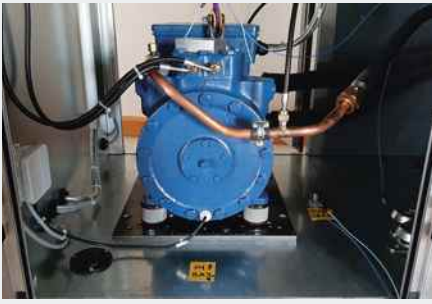
Lagerung eines Hubkolbenkompressors mit Isotop® MSN-DAMP
