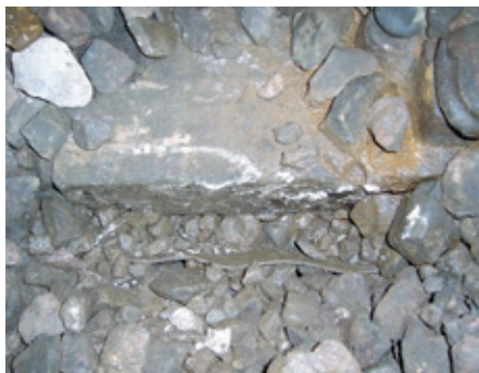
Abb. 2: Ausgebaute Holzschwelle mit beschädigter Befestigung
