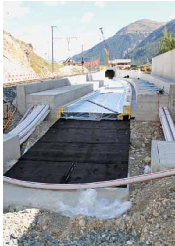
Bild 10: Übergangsbereich Feste Fahrbahn–Schotteroberbau mit Unterschottermatten Typ Sylomer® D 1519
