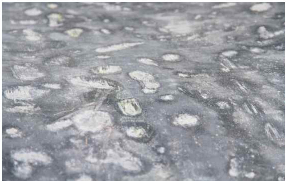
Abb. 3: Ausgebaute USM mit Abdrücken der Schotterkörner
