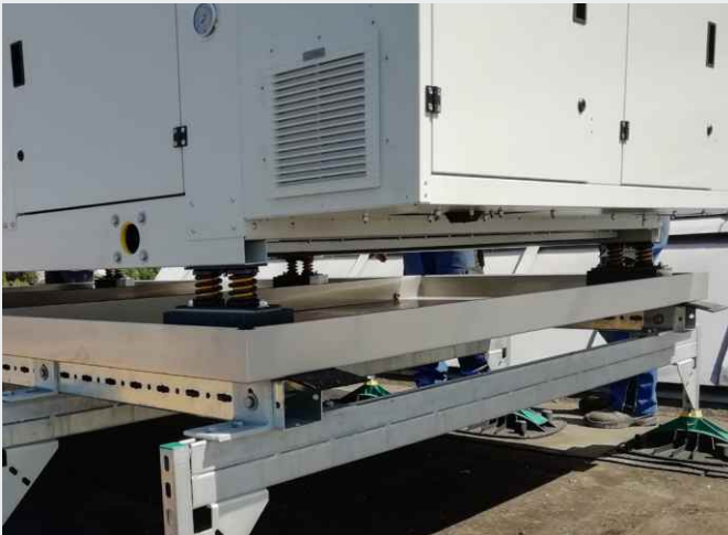
Geräteaufstellung in der Auffangwanne
