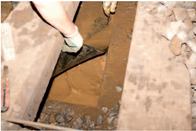
Abb. 3: Wasser auf der Tunnelsohle
