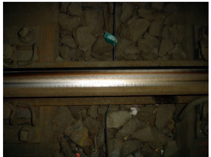
Abb. 5: Schienenzustand am Messpunkt 5 zum Zeitpunkt der Messung
