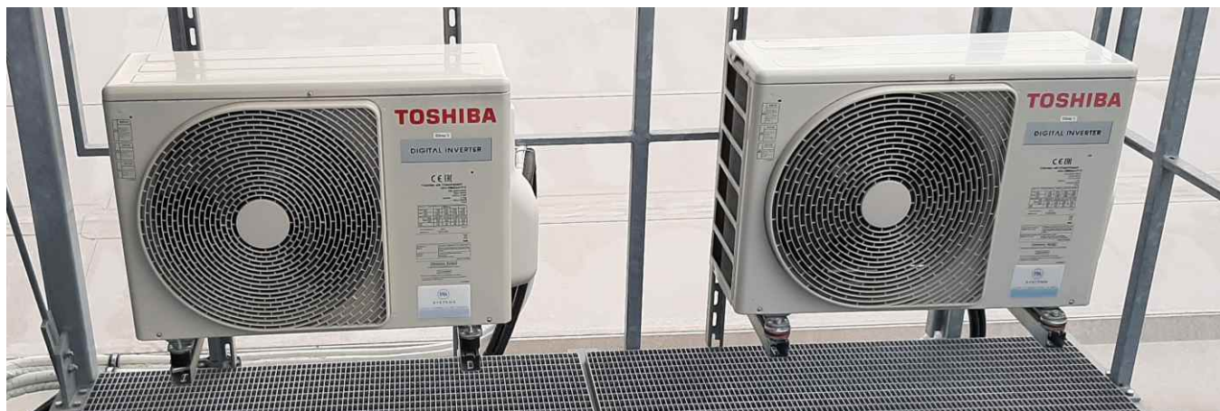
Deux unités extérieures identiques
