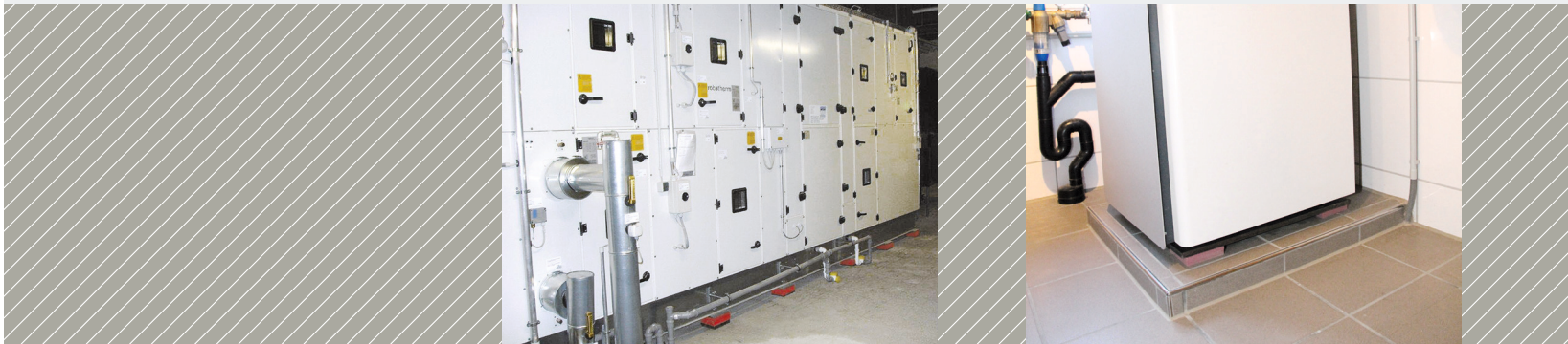
安装在 Isotop® SE 部件上的空调 (AC) 系统。
