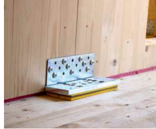
8 Kraftschlüssige Verbindungen zwischen den entkoppelten Elementen müssen ebenfalls entkoppelt werden (z.B. GEPI Winkelverbinder).
