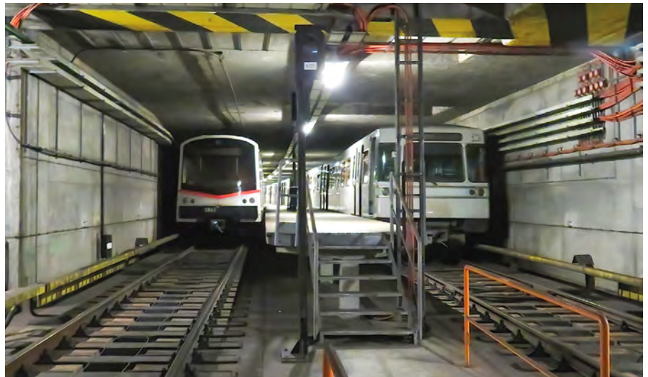
Bild 7: MFS im Bereich der Wendeanlage, links der neuere Zugtyp V, rechts der ältere Zugtyp U11
