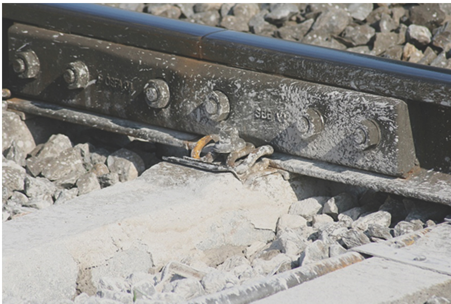
Bild 5: Bildung von Spritzstellen am Isolierstoß
