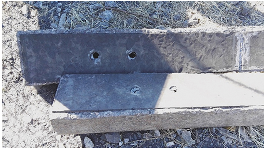
Bild 15: Ausgebaute besohlte Schwellen nach mehr als 1 Mrd. Lasttonnen
