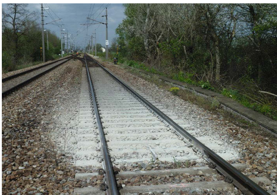
Abb. 5: Weiße Stelle durch Schotterzerstörung bei Isolierstoß
