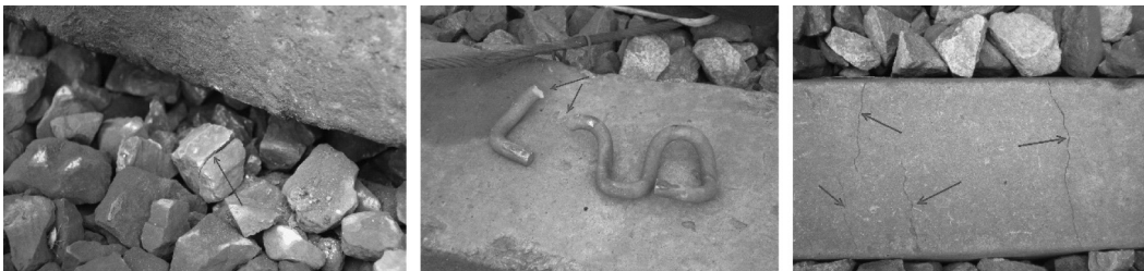
图2 普通混凝土轨枕导致的道砟破碎、弹条断裂和轨枕损坏
