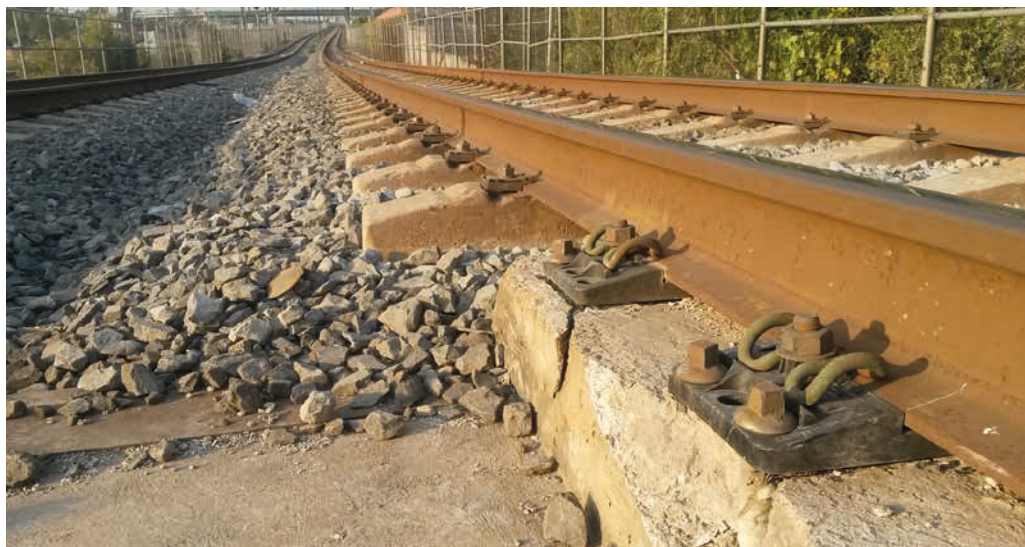
BILD 3: Auftretende Schäden am Übergang von Schotteroberbau auf eine Feste Fahrbahn
