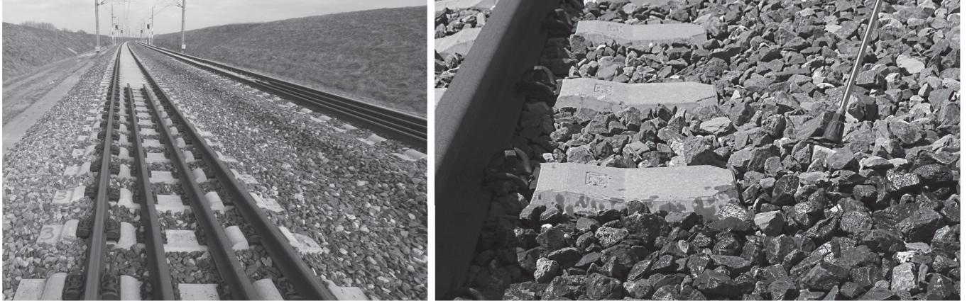
図-4 軌道構造境界部に敷設されたガードレール（左）. 表面を接着してバラストを固定
