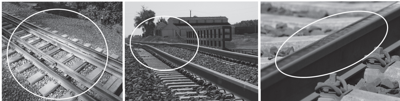
図-3 軌道構造境界部に観察される磨耗の兆候：白石化（左）、バラスト沈下（中央）、短い間隔のレール波状磨耗（右）
