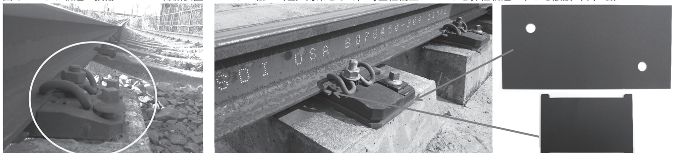
図-6 スラブ軌道の損傷 - レール締結装置のボルトの緩み（左）対策として、可塑性補正プレートと弾性軌道パッドを敷設（中、右）
