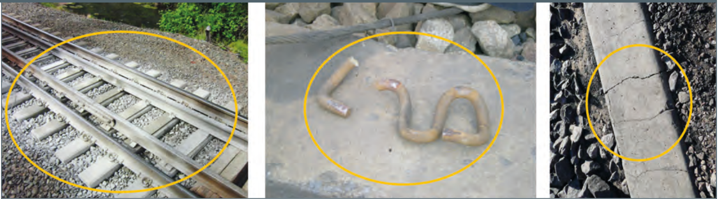
BILD 2: Weiße Stellen zeigen die Schotterzerstörung unter Betonschwellen (Bild links). Spannklemmenbrüche (Mitte) und Schwellenrisse (rechts) resultieren aus zu hohen dynamischen Belastungen
