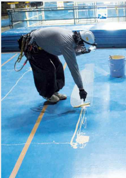
シロマー (Sylomer®) 2層目敷設時の接着剤塗布 ノロ止めのポリフィルム敷設
