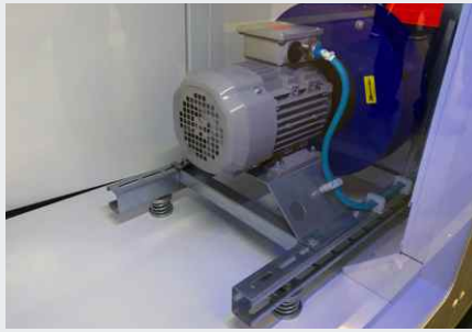
Radialventilator in einer RLT-Anlage
