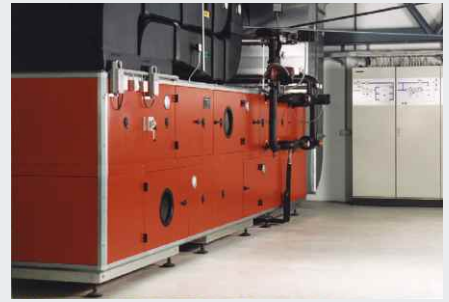
Im Keller aufgestellte RLT-Anlage
