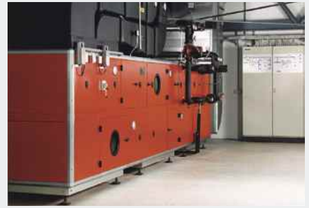
Im Keller aufgestellte RLT-Anlage
