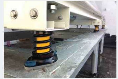
Rückkühler auf Dach installiert
