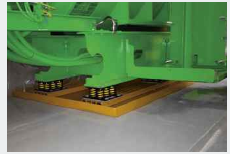
Großes Blockheizkraftwerk mit vielen Start- und Abschaltzyklen
